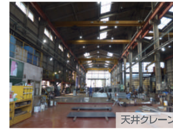
天井クレーン
